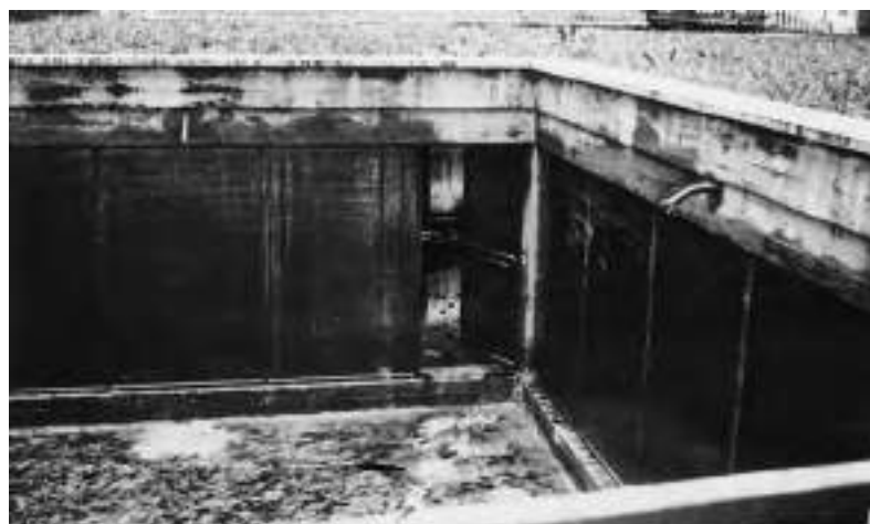
Fig. 11. Trento, via A. Rosmini. Il sito dopo l'alluvione del novembre 1966.
