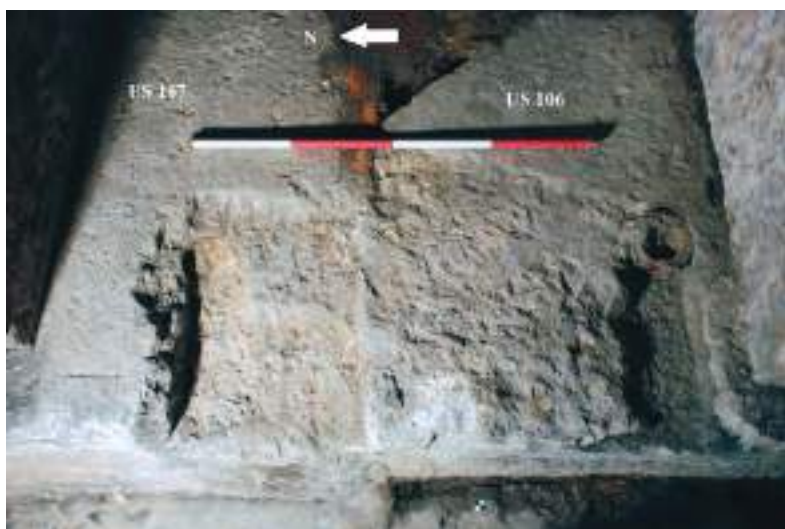
Fig. 10. Trento, Torre Bellesini. I pilastri nn. 1 (US 106) e 2 (US 107).
